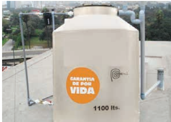
Tanque de almacenamiento de Agua Potable.
